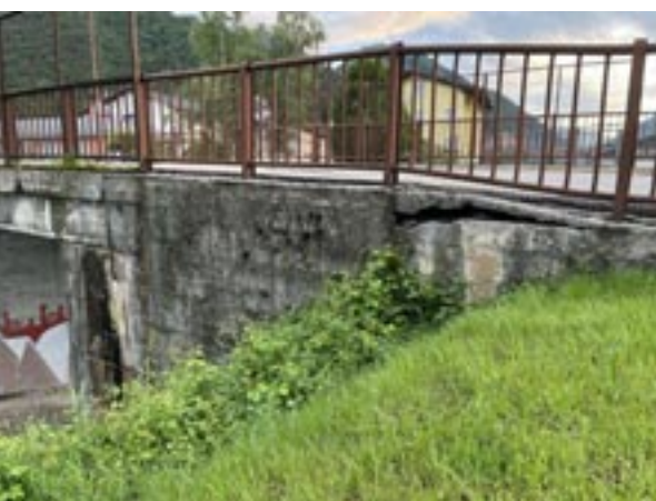
Un dettaglio degli ammaloramenti sul ponte di via Spagolla
